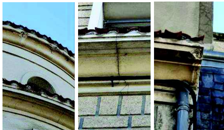
Dégradation des corniches
