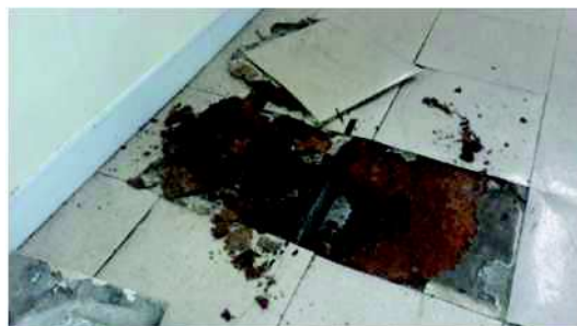
Platelage bois dégradé supporté par bac acier
