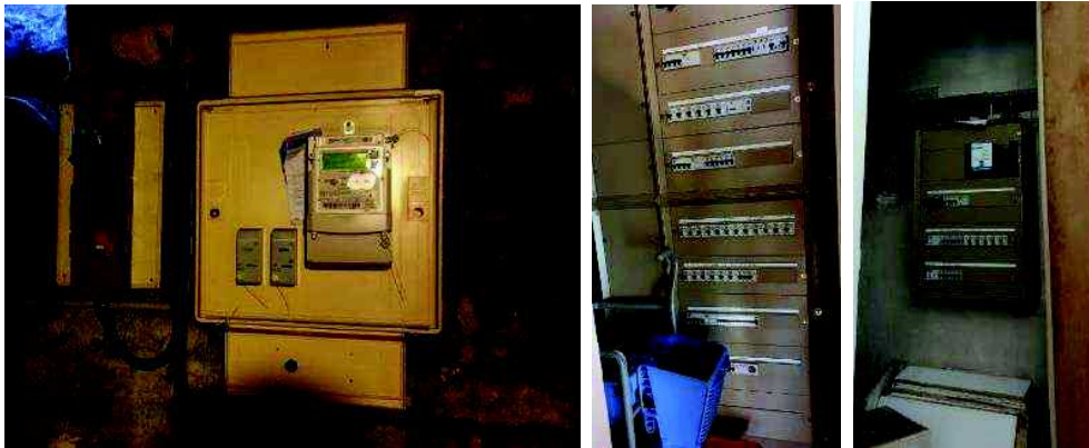
Arrivée électrique (à gauche) / TGBT (au centre) / armoire divisionnaire du R+2 (à droite)
