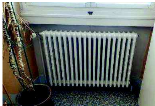
Radiateur fonte au RDC
