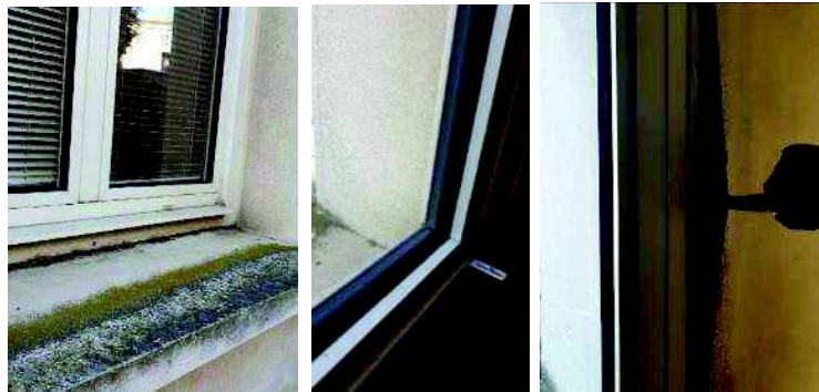
Châssis isolé (à gauche et au centre) / défaut d'étanchéité des façades (à droite)
