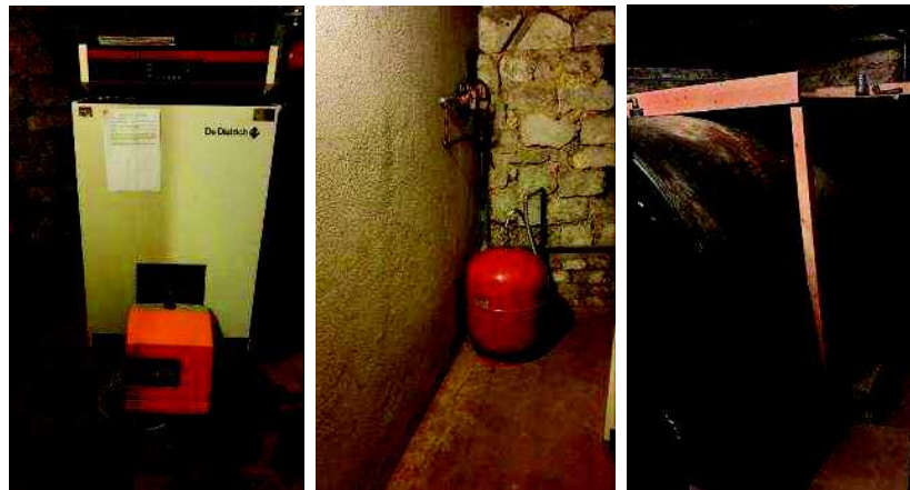
Chaudière DE DIETRICH (à gauche) / ballon d'expansion (au centre) / cuve (à droite)
