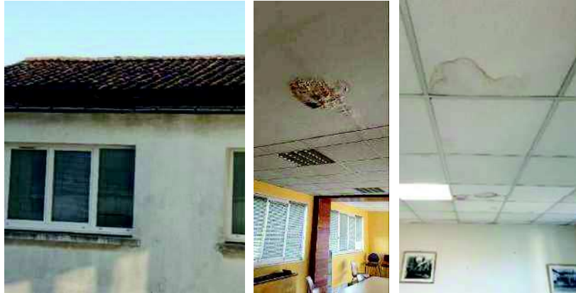
Couverture tuile (à gauche) / Infiltrations visibles au R+2 (au centre et à droite)
