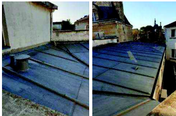
Couverture zinc à joint debout
