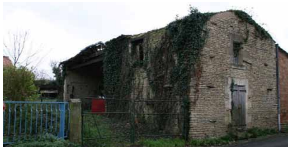
Bâtiments agricoles abandonnés
